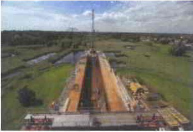
„Vor-Kopf-Bauweise“ - eine ingenieurtechnische Herausforderung. Die Auenlandschaft darf beim Bau der Saale Elster-Talbrücke nicht betreten oder befahren werden. Foto: Frank Eritt
